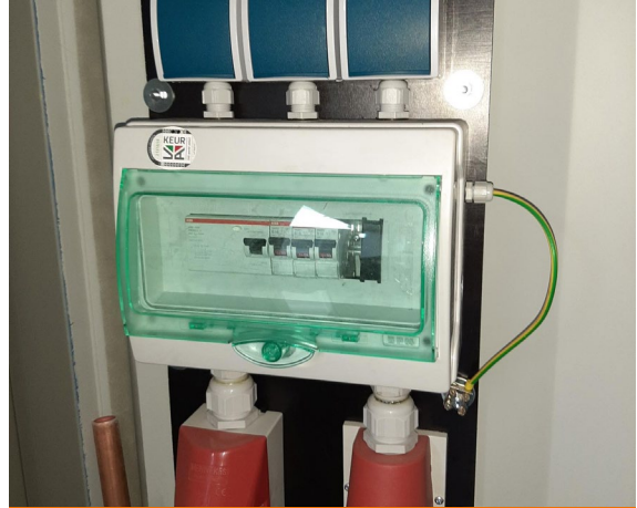
Groepenkast in materiaalcontainer met sticker
