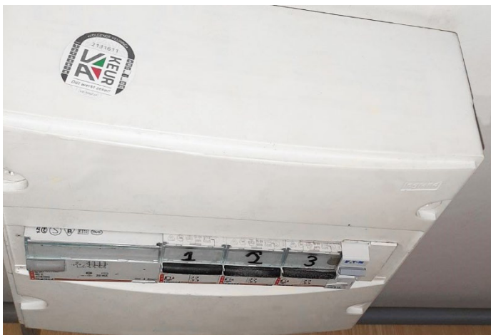
Groepenkast in directiecontainer met sticker
