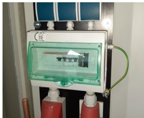
Groepenkast in materiaalcontainer met sticker
