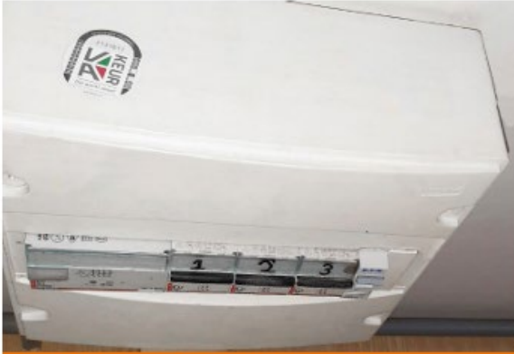
Groepenkast in directiecontainer met sticker
